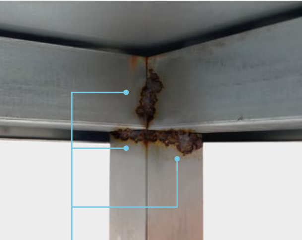
Oxidación por soldadura
